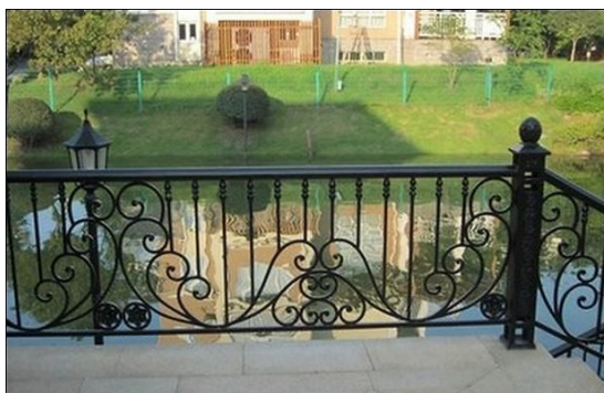
Figura 85: Exemplo de corrimão de ferro como proteção a instalar nos locais de maior perigo de queda.
